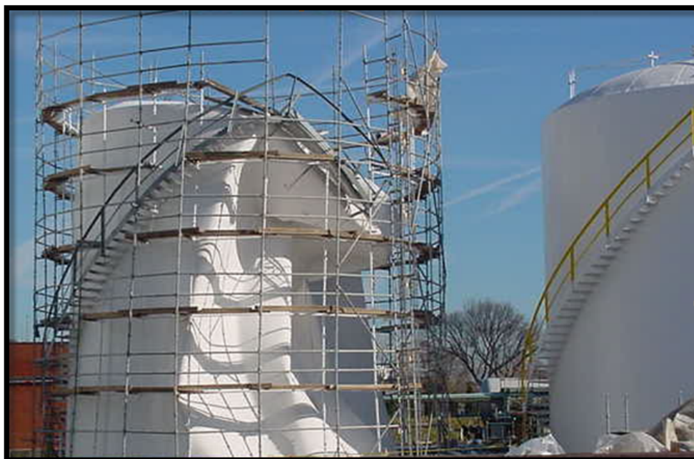
تصویر ۷۳۹: تخریب مخزن هنگام تخلیه بدلیل عدم رعایت باز بودن ونتهای سقف
